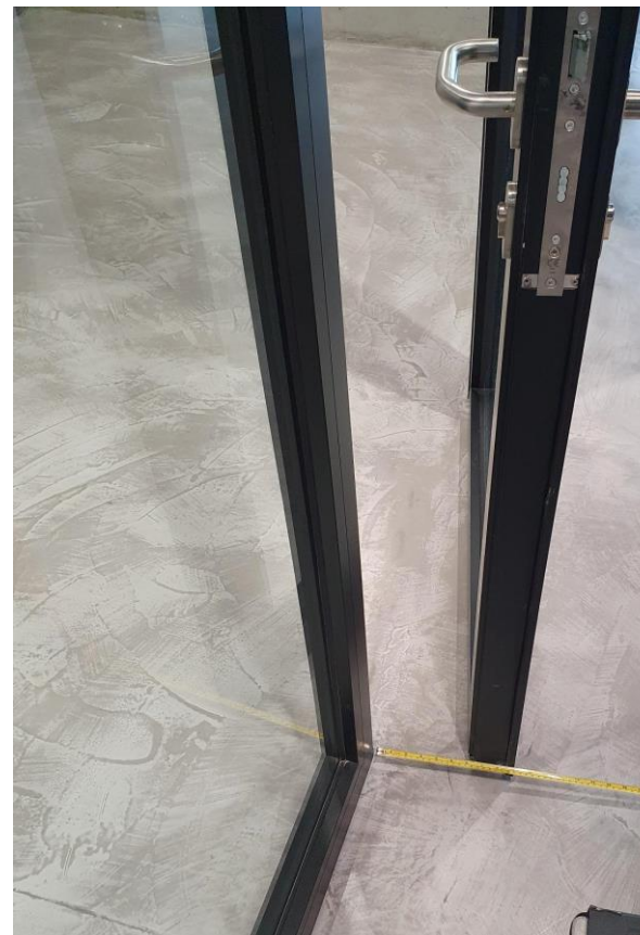
Drzwi niedomknięte za skutek działania nadciśnienia w klatce schodowej. Szczelina o szerokości 18 cm
