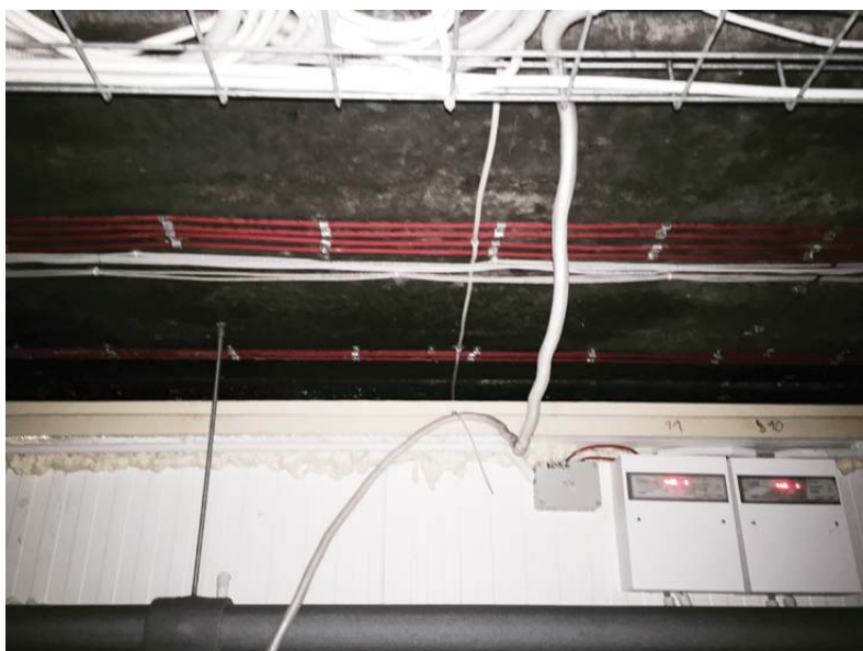
Rys. 14. Wyraźne zawilgocenie stropu. Zdjęcie zrobione w kwietniu, a więc przy niewysokich jeszcze parametrach powietrza zewnętrznego (temperatura i wilgotność). Warto zwrócić uwagę na nagromadzenie instalacji w przestrzeni międzystropowej, która poddawana jest dużemu wpływowi wody
