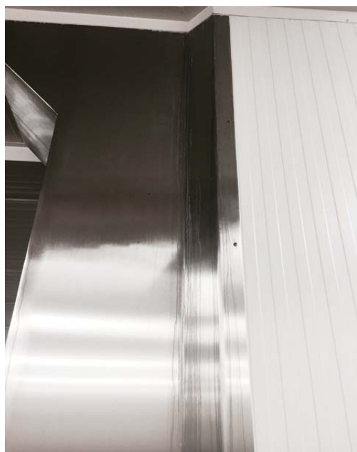
Rys. 15. Widoczne zacieki na ściankach wewnątrz komory chłodniczej na parterze
